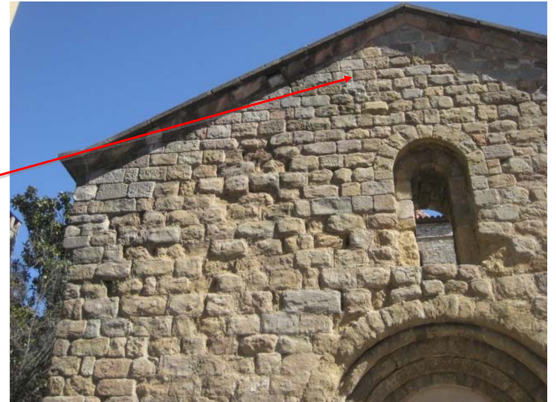
Degradació diferencial dels carreus de la façana. Detall d'un grup de carreus de la zona superior amb la superfície molt degradada i amb la formació de plaques i escates.
