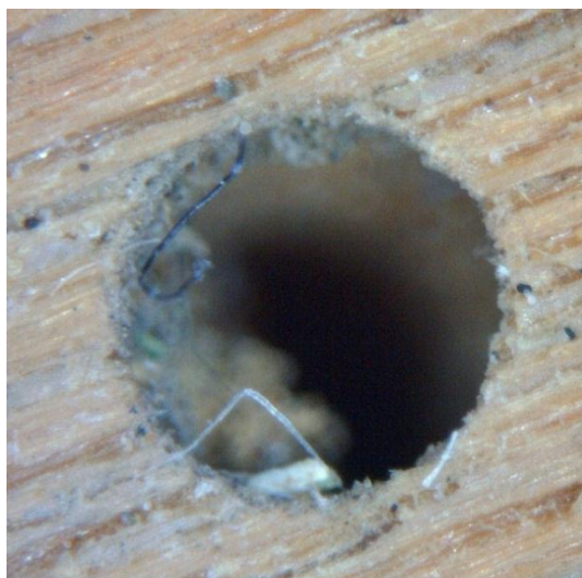
021_0115_AT_ML_atac_xilofag_travesser.jpg Perforacions produïdes en el travesser per xilòfags.
