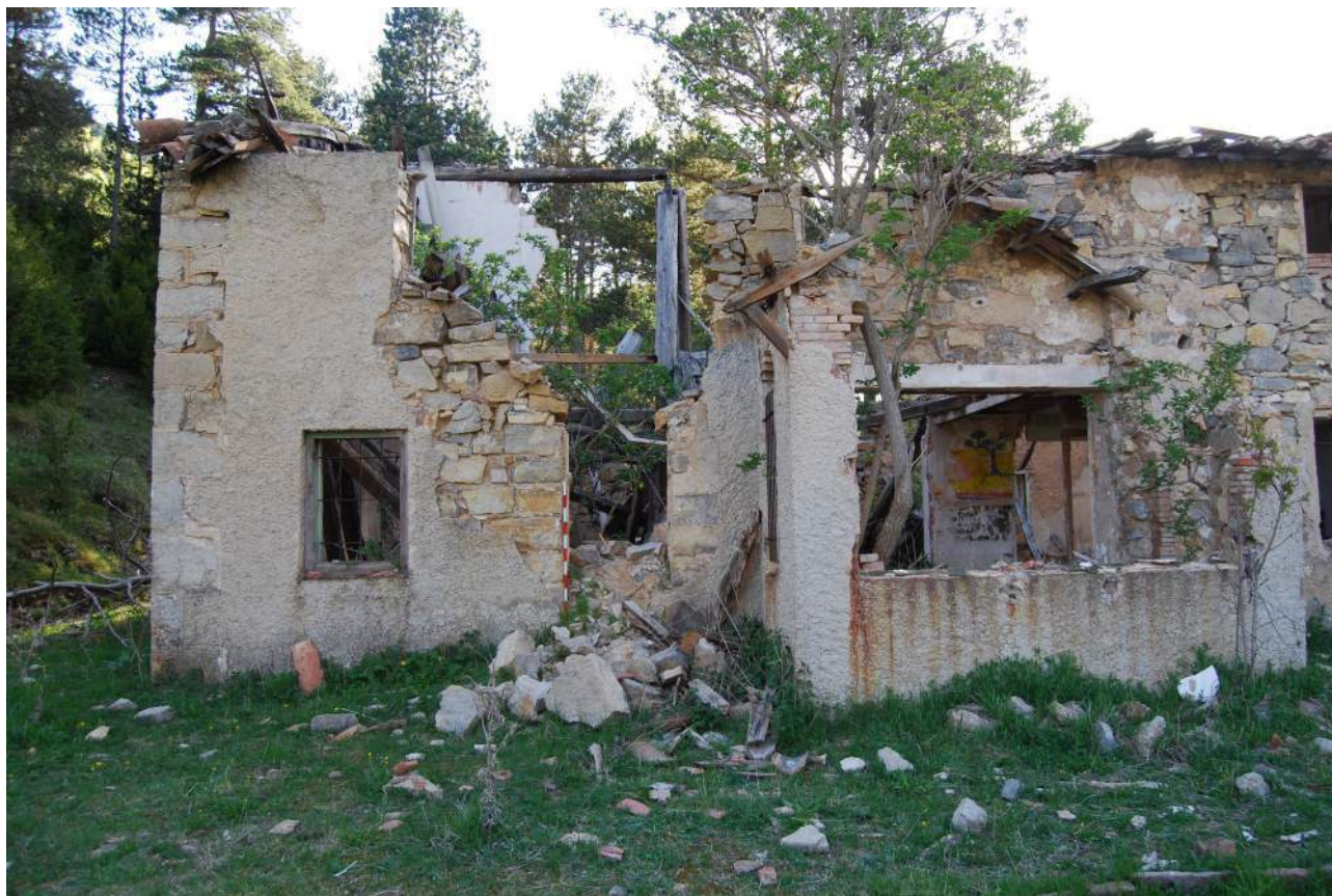
Fig.C 32: Estat actual de la façana principal de la Casa Wagner. Font: pròpia
