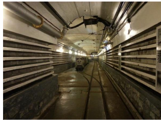
Galería secundaria donde se observan las canalizaciones de servicio
