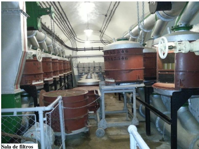
Sala de filtros
