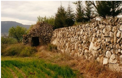
Fig. 27. Barraca 043 del PEP del terme de Montblanc adossada a un marge. Manel Martínez.
