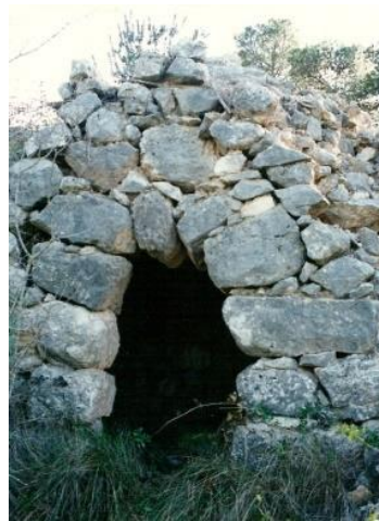
Fig. 32. Portal d'arc pla. Barraca 006 del PEP del terme de Montblanc. Manel Martínez.
