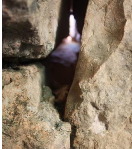
Fig. 83. Entrada d'aigua a l'interior de la barraca per pèrdua de material estructural. Font pròpia.
