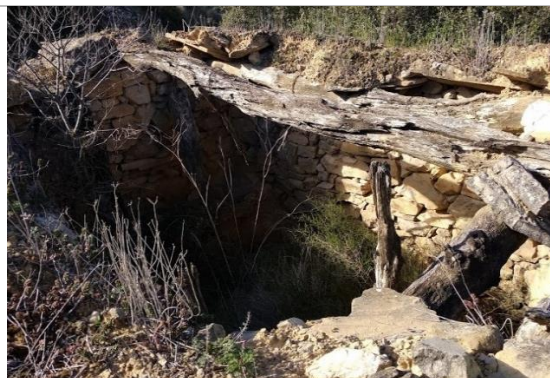
Fig. 80. Esfondrament total de la coberta degut a la degradació dels cabirons de fusta. Font pròpia.
