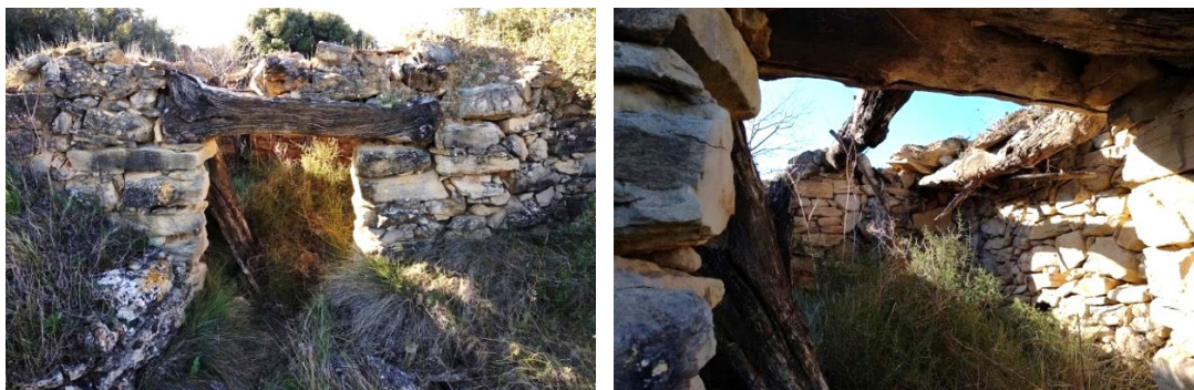
Fig. 23 i 24. Coberta esfondrada de cabirons de fusta i lloses. Barraca 092 del PEP del terme municipal de Montblanc. Font pròpia.
