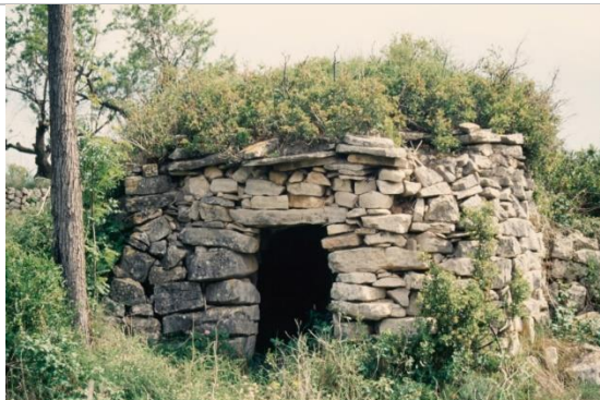
Fig. 78. Debilitament estructural per colonització de plantes superiors. Barraca 029 del PEP del terme municipal de Montblanc. Manel Martínez.
