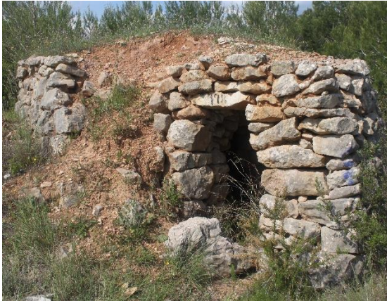
Fig. 76. Esfondrament parcial. Font pròpia.
