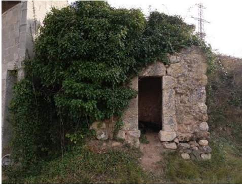
Fig. 11. Cabana de volta de canó 079 del Pla Especial de Protecció del terme municipal de Montblanc. Vista exterior. Font pròpia.
