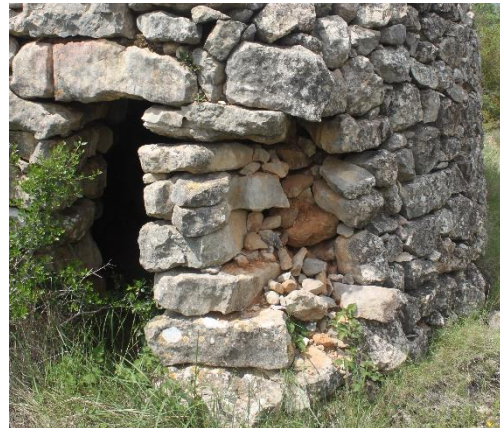
Fig. 77. Esfondrament parcial. Font pròpia.
