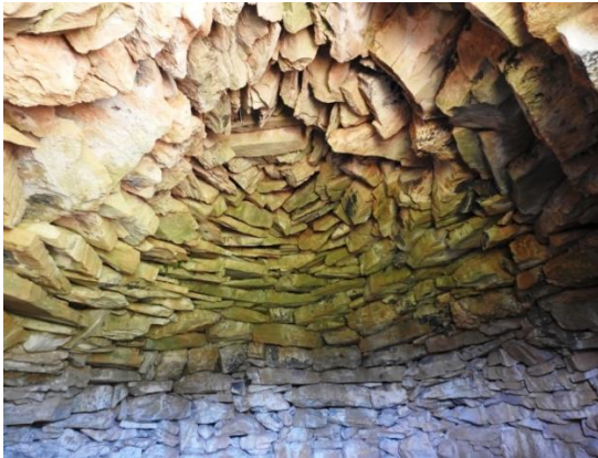
Fig. 8. Barraca de falsa volta 082 del Pla Especial de Protecció del terme municipal de Montblanc. Volta acabada amb llosa (cobertora). Manel Martínez.
