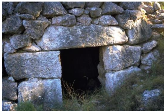
Fig. 34. Llinda de la barraca 020 del PEP del terme de Montblanc. Manel Martínez.
