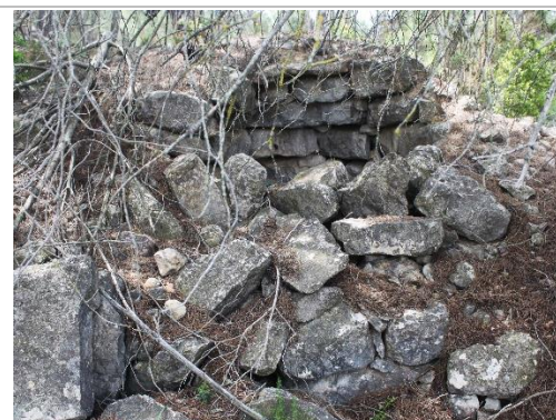
Fig. 81. Coberta semiderruida. Font pròpia.
