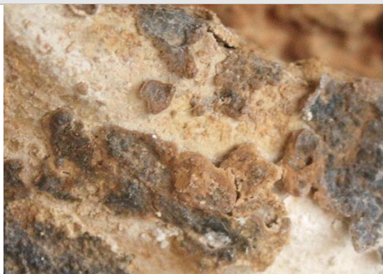
Fig. 55. Despreniment en descamacions causada pel biodeteriorament. Font pròpia.
