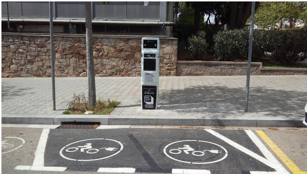
FIGURA 14. Estació de càrrega de motos elèctriques al carrer de Pascual i Vila al Campus Diagonal.
