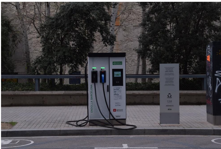
Fotografia 31, 32 i 33. Laterals de l'edifici Media Tic i punt de càrrega de vehicles elèctrics al C/ de Roc Boronat.
