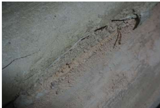
Figura 109. Aspecte de pols del morter del nervi a una volta lateral afectada per les sals i la humitat. (Font pròpia)
