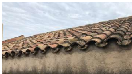
Figura 99. Taques al morter per la incipient aparició de pàtina biològica amb la forma de la baixada d'aigua des de la coberta. (Font pròpia)
