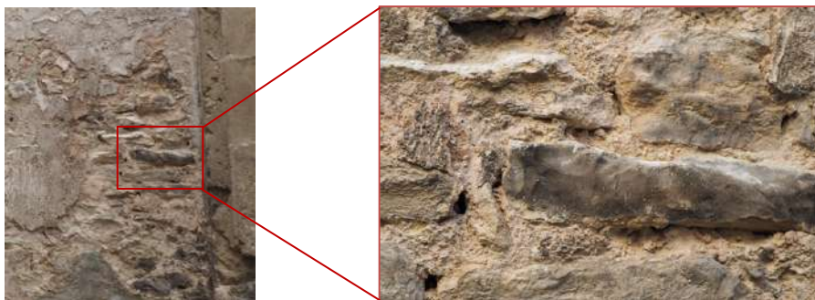
Figura 100. Ennegriment a causa de la cremada pel foc del material petri de la façana. (Font pròpia)
