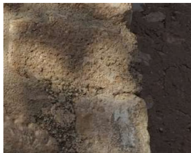
Figura 93. Erosió del material petri ubicat a la cantonada de la façana. (Font pròpia)
