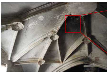
Figura 115. Ennegriment al voltant d'una perforació a la volta de la nau lateral. (Font pròpia)
