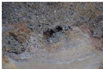
Figura 91. Disgregació del morter de calç sobre el material petri de la façana. (Font pròpia)
