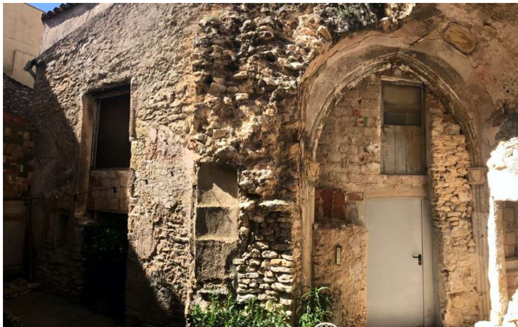
Figura 36. Façana nord. S'hi observen restes del que podria haver estat una nau lateral o una capella lateral. Inicialment no feia funció de façana, però ha estat modificada per adaptar-se als nous usos. (Font pròpia)
