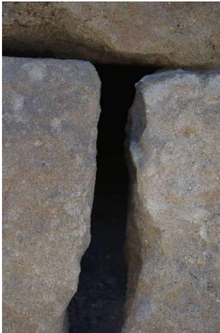
Figura 11. Detalle de unión entre dos sillares, mortero desgranado, no es visible superficialmente.
