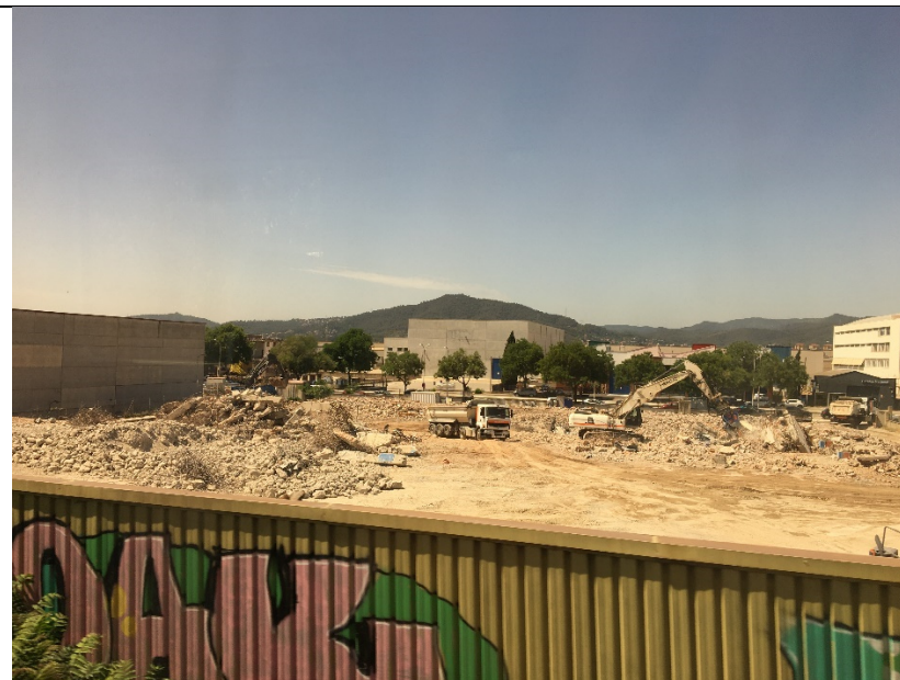
Fotografia 22: destrucció d'una nau industrial al polígon del Pla, a l'Av. de Barcelona 233, a Molins de Rei, 03/06/2022.
