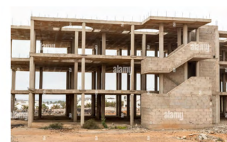
Figura 70. Edificio inconcluso (2022). Islas Canarias, España. Extraído de: https://www.alamy.es/foto-edificios-inacabados-en-zona-turistica-de-costa-teguise-lanzarote-islas-canarias-espana-104745066.html
