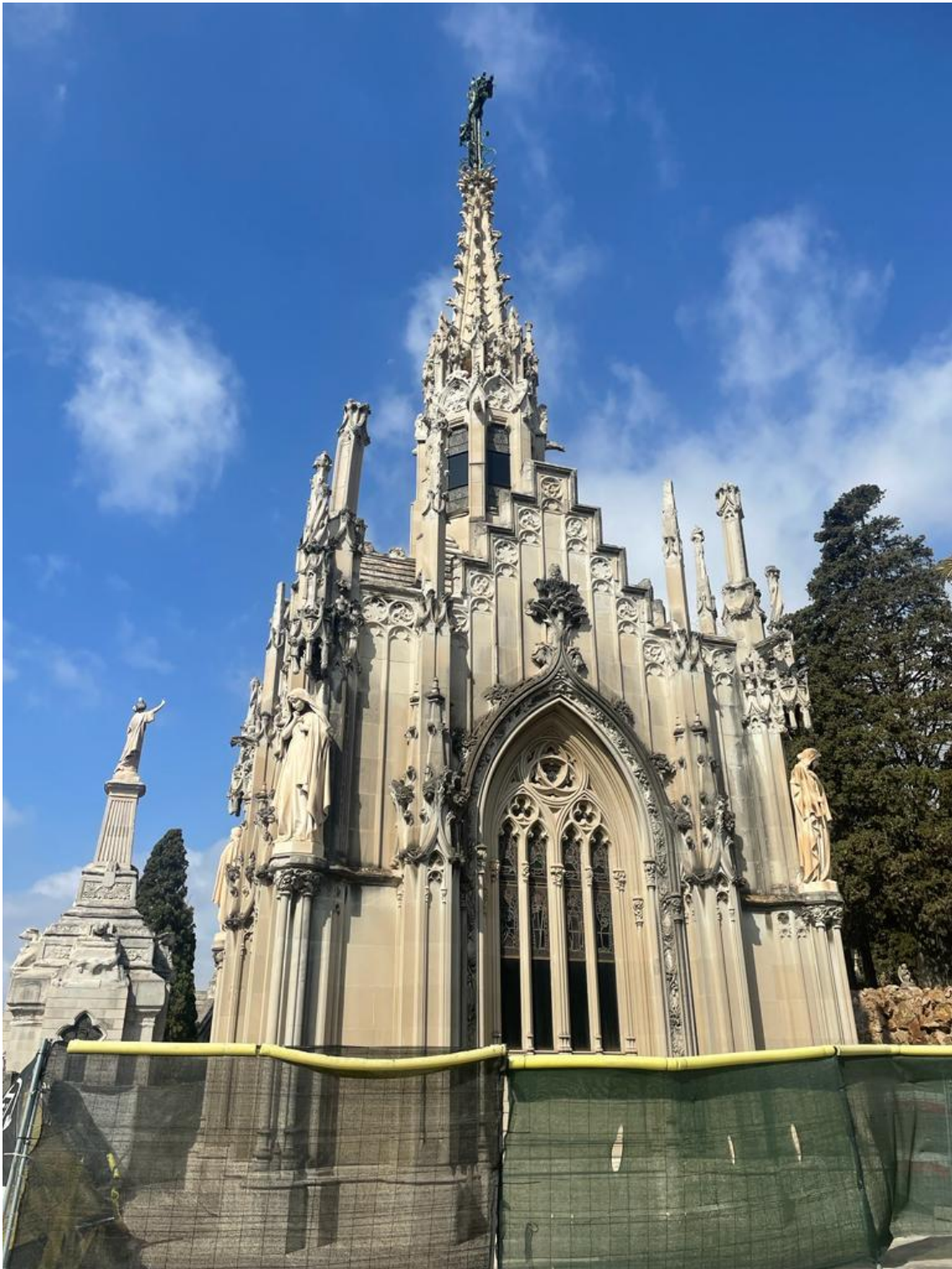
Fig. 49. Façana dreta lateral del Panteó Josep Gener, de Josep Majó, actualment en obres.
