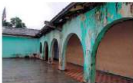
Imagen 17: Ibagué. Instituto Politécnico Luis A. (GIP/CAE) Benegilo. Familia Entorno Infancia FE. Vista externa patio principal. Se evidencia el estado de deterioro de las paredes, los arcos. Predominio de humedad, malos olores y falta de ventilación
