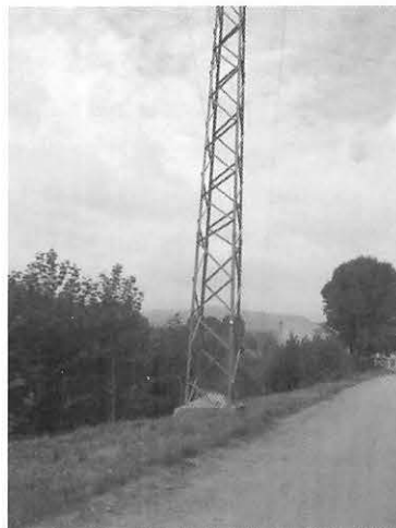
Pal de la xarxa elèctrica que travessa el riu a l'alçada de la resclosa de la Teula. (Font: Arxiu propi)
