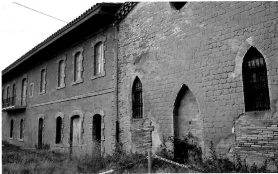
Estat de la façana de l'església i els habitatges dels treballadors l'estiu de l'any 2006. (Font: Arxiu propi)
