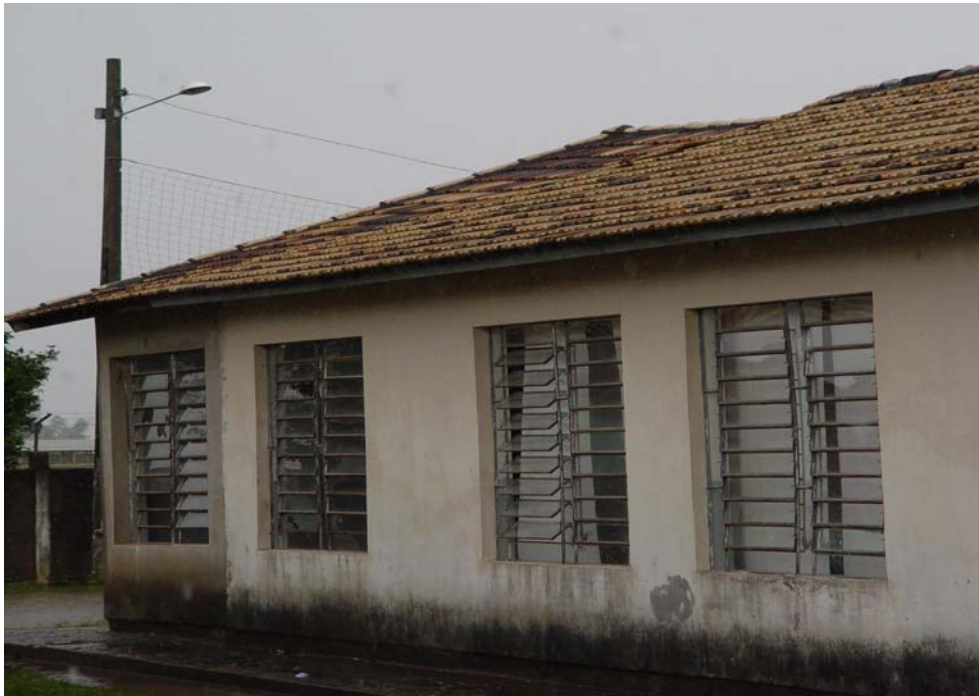
Foto 15 - Escola Básica Noé Abadi. Parede externa.
