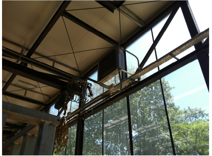
Sistema de calefacció.
