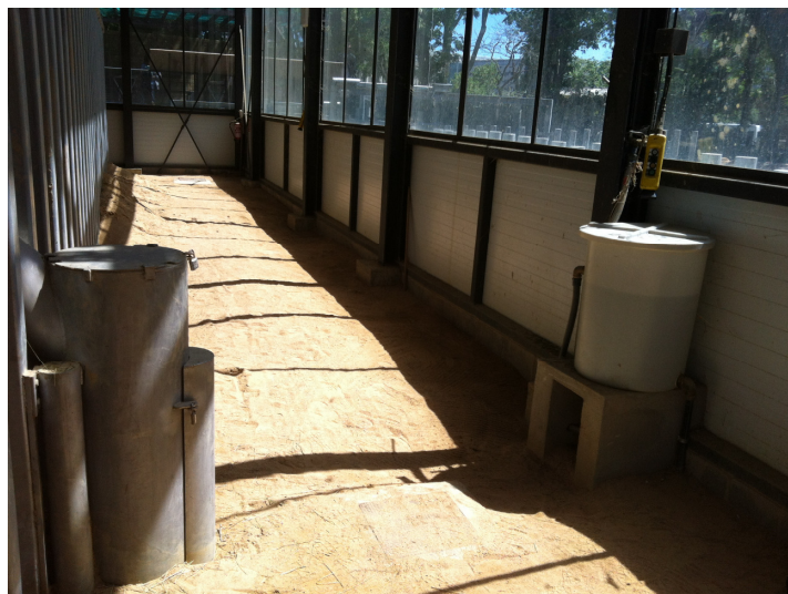
Sistema de l'aigua fet amb dos dipòsits.
