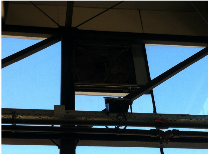
Sistema de refrigeració.
