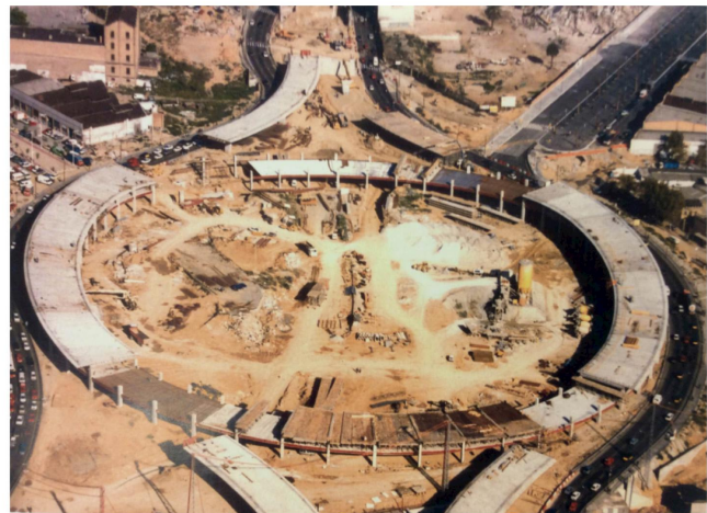
Fig. 26 Construcción del Tambor vial en Glorias para las olimpiadas, 1991. Fuente: Rui-Wamba, J. Guerrero, S. La plaza de las Glorias Catalanas. 2009.
