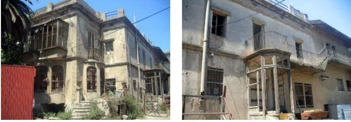
Fig.515,516>Restes de la façana interior de la fàbrica d'Enric Sanchis (2009). Font: fotografia aportada per Josep Capdevila en les 1es. Jornades Participaves a Bona Pastor.
