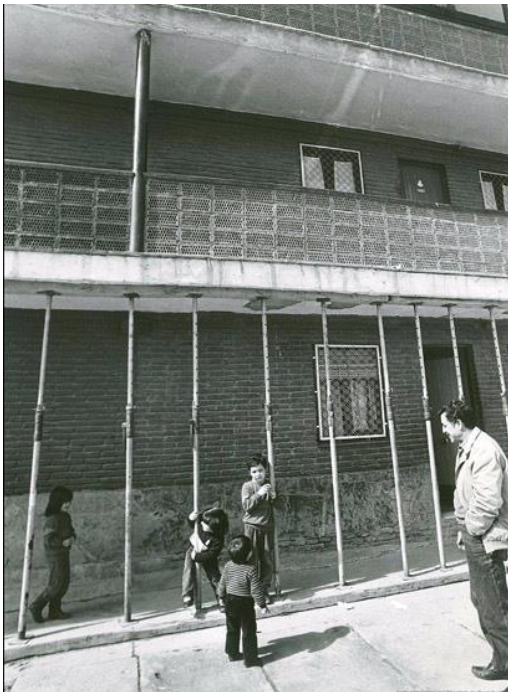
Fig.242>Edificis apuntalats afectats per l'aluminosi. Font: aportació IVes Jornades Participatives BdV
