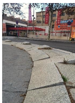
Ilustración 169. Pavimento y vado peatonal deteriorado. Fuente: Fotografía propia de la autora. 2015
