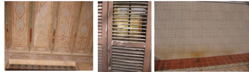
Algunes de les parts que es veuen afectades dins l'immoble
