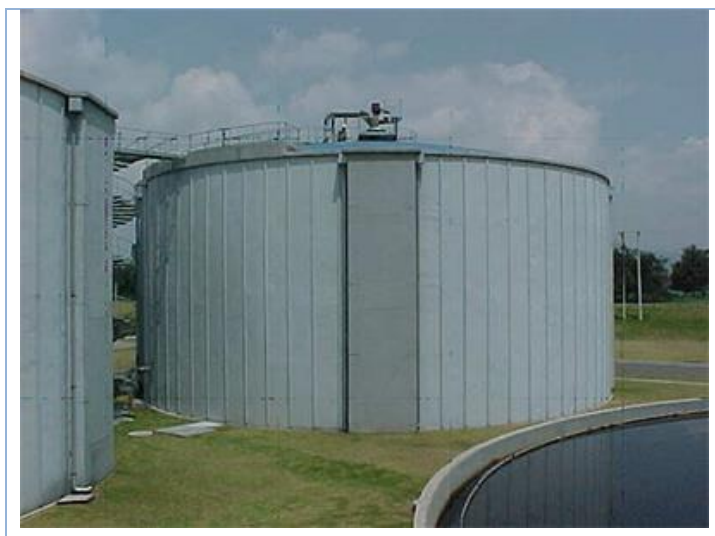
Figura 4. Digestor anaerobio PTAR El Salitre. Fuente (EEAB, 2018)
