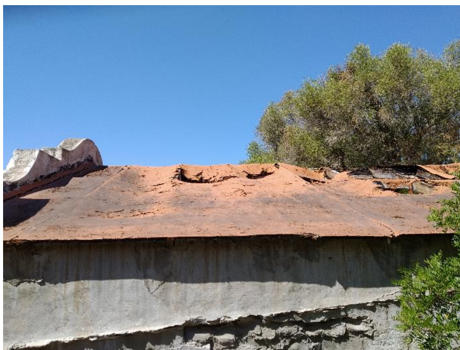
Estat de la teulada. Font: Fotografia pròpia, agost 2020
