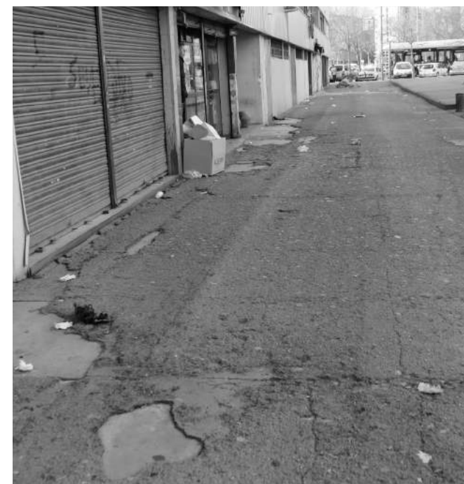
Imagen 146: Deterioro espacio público Mina Nova. Fuente: Propia, 2016.
