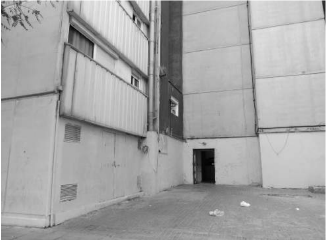
Imagen 136: Edificio Venus en deterioro. Fuente: Propia, 2016.
