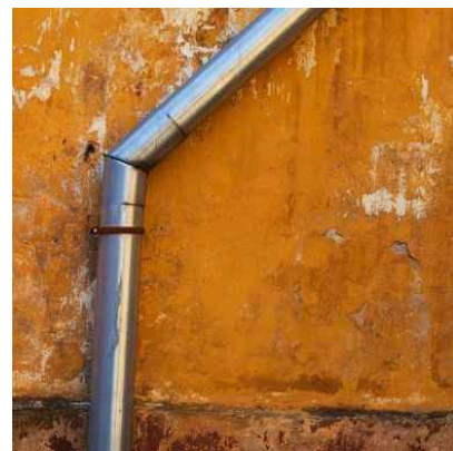
Figura 5 - Butllofes, desprendiments i pèrdues de pintura i revestiment causades per les filtracions d'aigua. © OK Humedades
