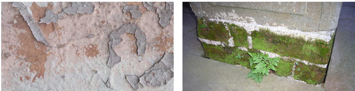
Figura 9 - (a l'esquerra) Alteracions causades per la humitat i la formació de sals en el mur. © Arquitectura sana Figura 10 - (a la dreta) Aparició de floridures, algues, líquens i plantes superiors en la part baixa d'un pilar de pedra. © La restauradora de la Laguna
