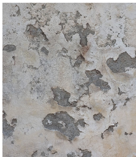
Figura 1 - Efectes de la humitat en pintures i revestiments de calç d'una façana qualsevol. © Victoria Herrero
