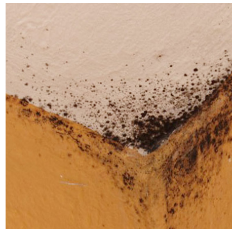
Figura 4 - Fongs i floridures en parets i sostres que han aparegut amb el temps a causa de la humitat condensada. © TSA Conservación de Patrimonio
