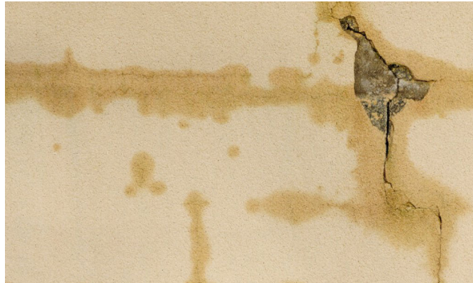
Figura 6 - Les humitats accidentals es manifesten habitualment a través de diferents patologies constructives, en aquest cas, té lloc l'aparició d'esquerdes, fissures i taques localitzades. © Revetón
