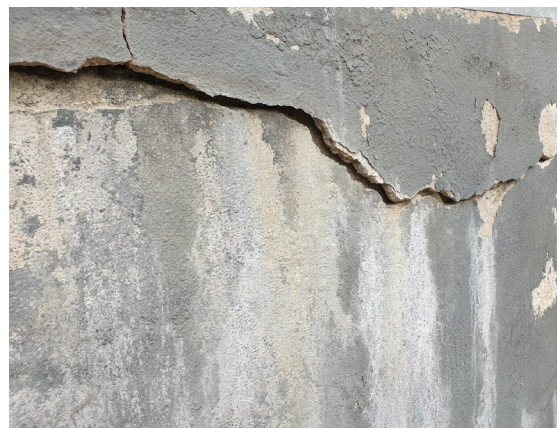
Figura 8 - Esquerdes i fissures causades per la sobrecàrrega de forces, els moviments de l'edifici i la mala qualitat dels materials. © Joan Tarifa
