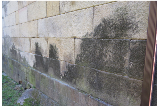
Figura 3 - L'aigua provinent del terreny ascendeix creant taques d'humitat horitzontals i afavorint l'aparició de biodeteriorament en la part baixa del mur de maçoneria. © Centre Tecnològic del Granit
