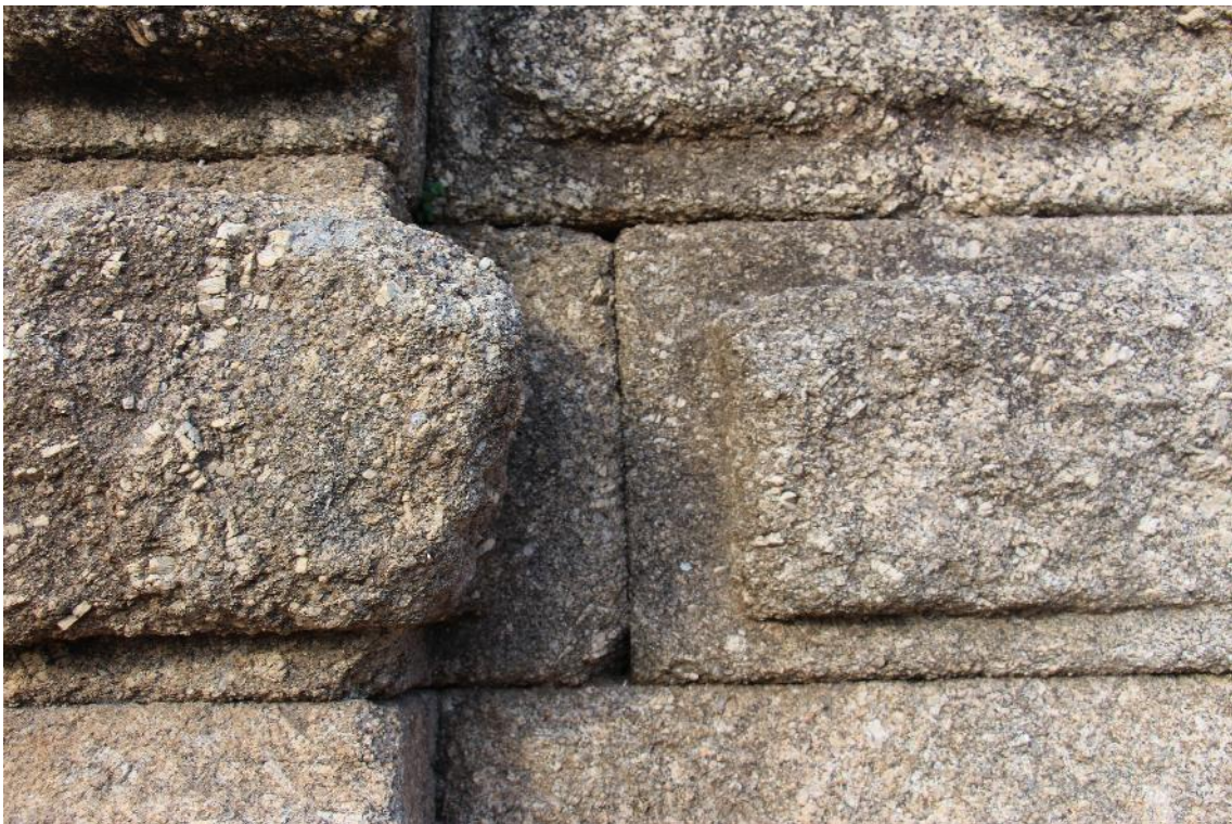
Fig. 35. Rebajos en las esquinas de los sillares (autora).
