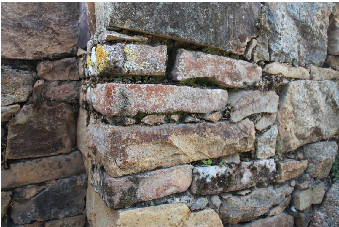
Fig. 40. Ejemplo del empleo de hiladas de ladrillo para nivelar la mampostería (tramo 3) (autora).
