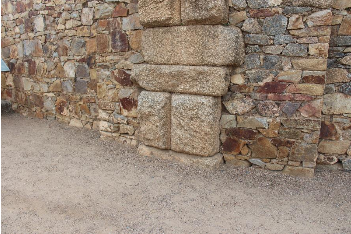
Fig. 38. Desproporción entre los tizones de una misma hilada (tramo 5) (autora).
