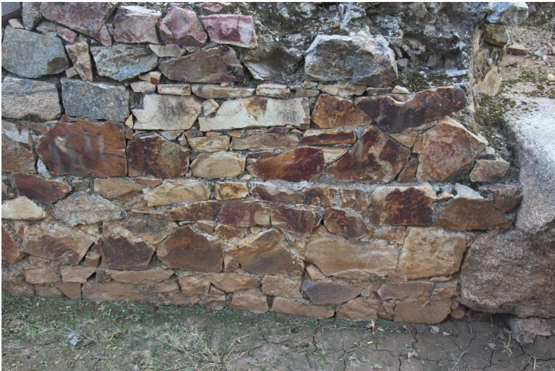
Fig. 51. Rectificación en la ejecución de obra en el Pa19 (autora).
