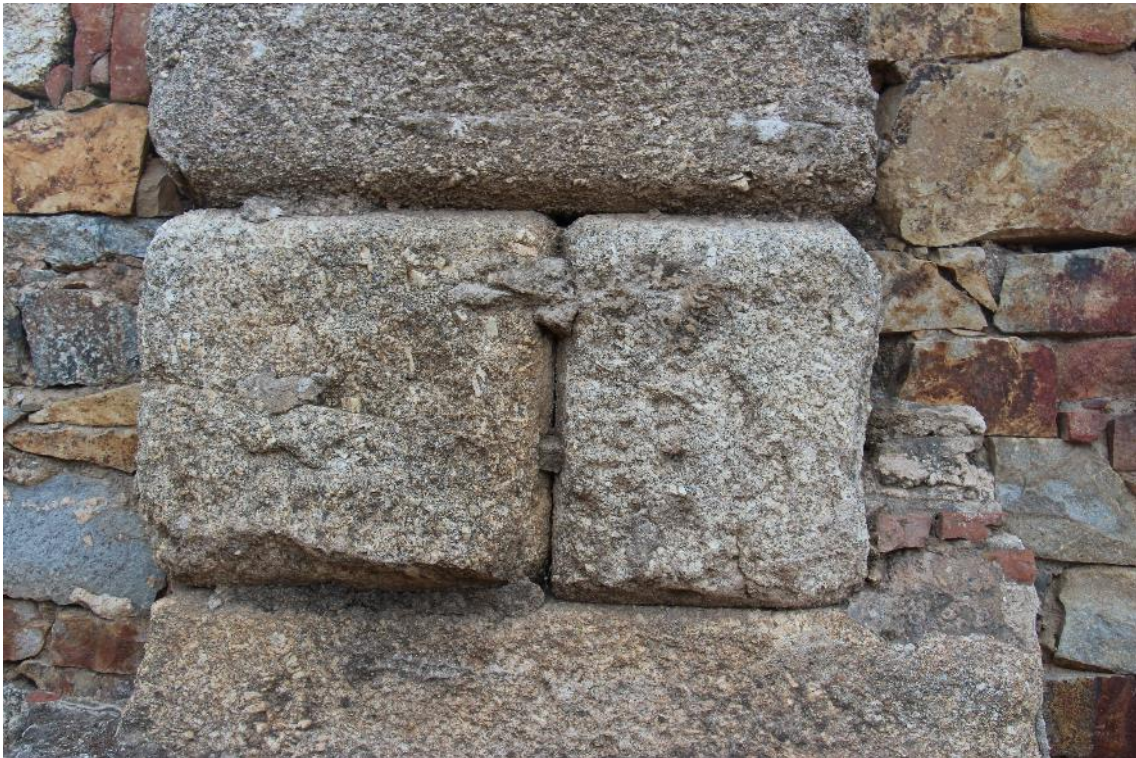
Fig. 17. Mortero adherido a los sillares graníticos (tramo 5) (autora).
