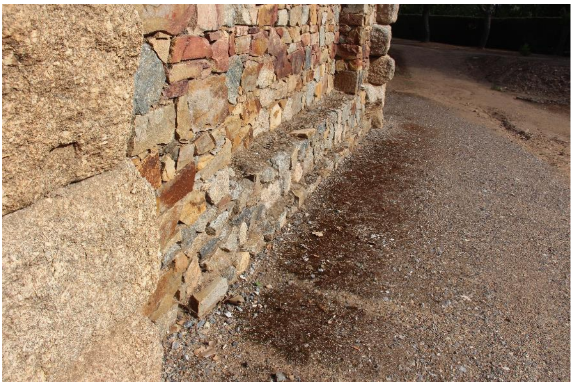
Fig. 50. Rectificación en la ejecución de obra en el zócalo del Pa16 (autora).
