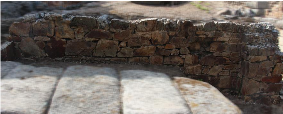
Fig. 60. Detalle de la regularidad de las tongadas en el tipo técnico-constructivo B (tramo 12) (autora).
