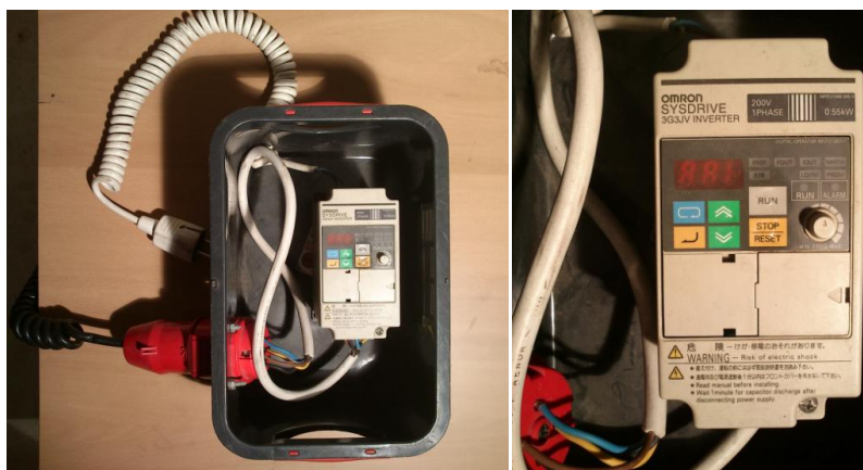
Figura 2-4. Izquierda, montaje del panel de control para la regulación de la f a partir de un variador de frecuencia; derecha, detalle del variador (Omron Sysdrive 3G3JV INVERTER).
