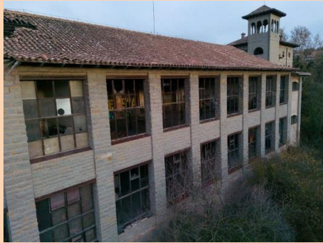
EN AQUESTA FOTOGRAFIA ES POT OBSERVAR L'APARENÇA ACTUAL DE LA FAÇANA OEST DE LA NAU LATERAL 1. ES PROPOSA PODER RECUPERAR ELS VIDRES I LES FUSTERIES QUARTERADES. FONT: TARADELL.COM
