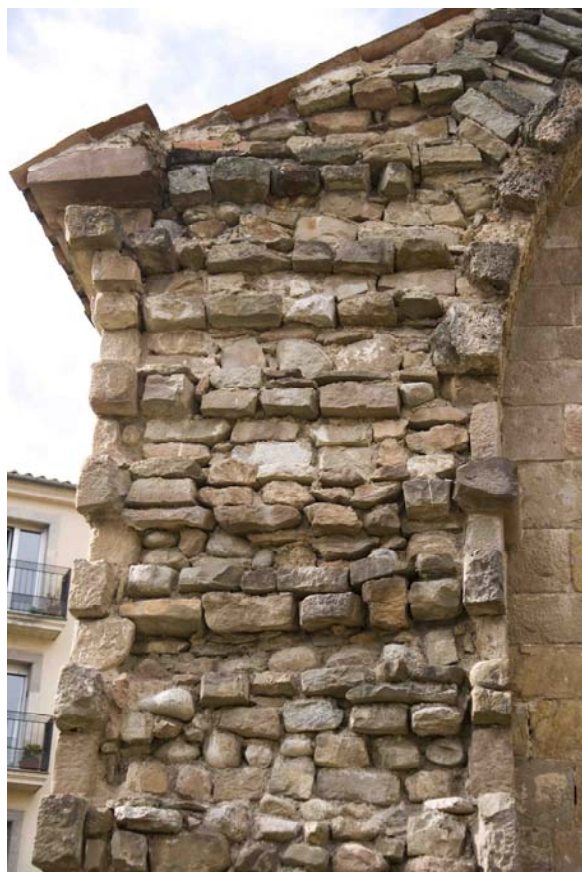
Paret lateral de l'església de Sant Pol, fruit de la restauració dels anys 60, on es pot observar el possible reblert de l'interior dels murs.
