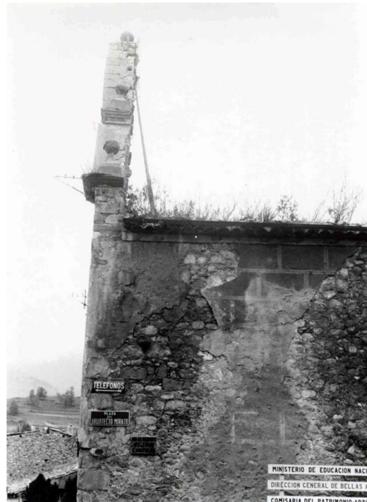
Pedres de l'ampliació barroca i restes del carreuat barroc a l'exterior de la nau lateral. 1960
