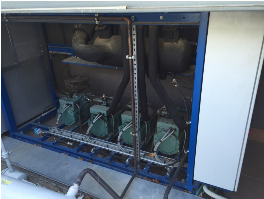
Ilustración 2. Sistema de refrigeración con multicompresor
