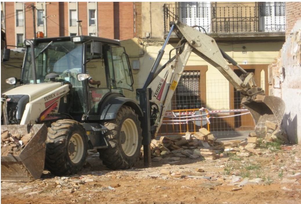
Destruint el mur que s'havia aixecat per separar els enderrocs del carrer
