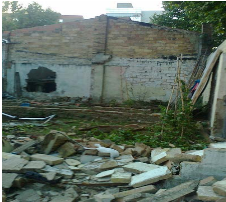
Destrucció de l'hort_agost 2011
