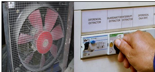
Fig. 4. Protecció col·lectiva, connexió del sistema d'extracció.
