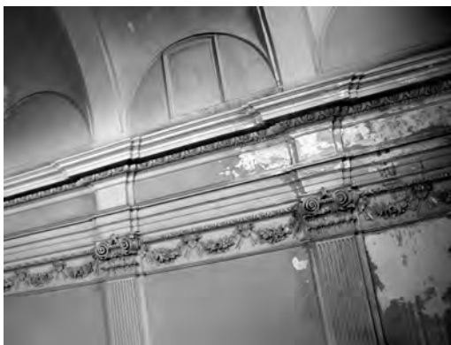
Figura 1. Vista d'un sector del mur sud de la capella abans de la intervenció. S'observen la capa de pintura de color gris i les pèrdues causades per les filtracions de l'aigua de pluja des de la teulada.
