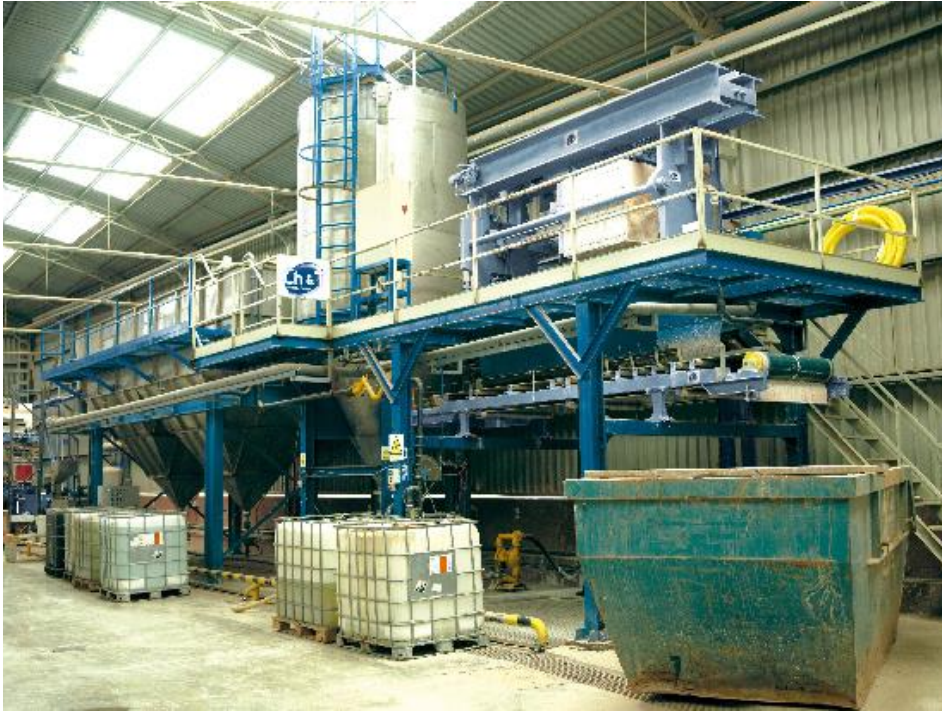
Figura 1.5. Depuradora fisico-química per al tractament d'aigües residuals formada per un tanc de neutralització, dos decantadors i un filtre de premsa (Chumillas and Tarongi, 2014).
