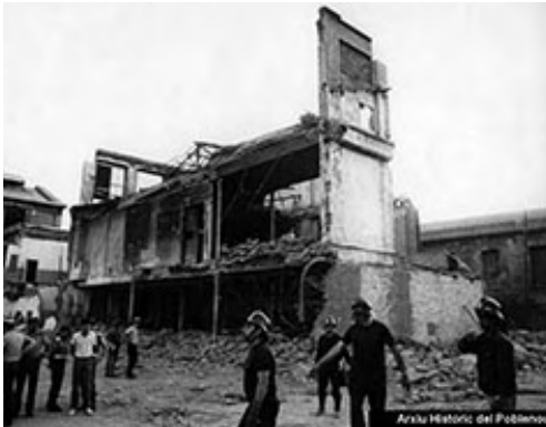
Figura 34. Edificios de fábrica Catex en proceso de demolición. Accidente producido el 14 de julio de 1984.
