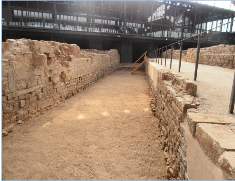
Figura 17 - Tram del Rec Comtal al Mercat del Born, un cop restaurat. A mà esquerra s'observa el mur delimitador de la séquia que també feia la funció de façana dels habitatge d'aquesta banda, amb la presència d'obertures que donaven directament al canal.
