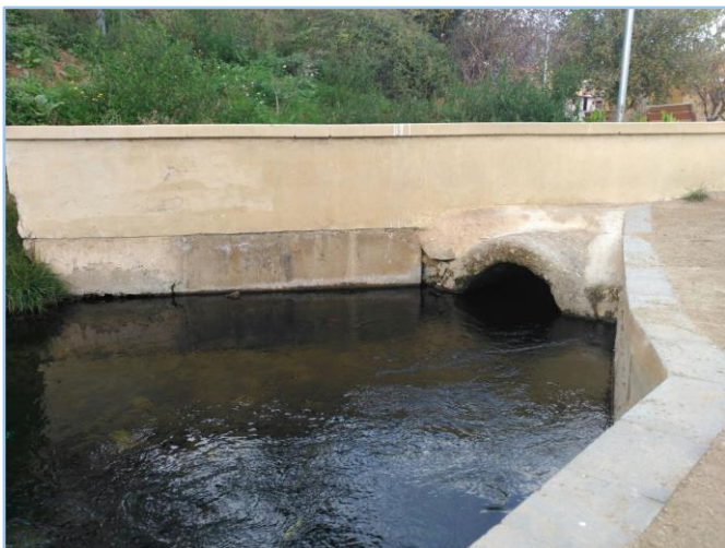
Figura 7 - Canalització semicircular i part de la bassa, des del sud. Font: pròpia.
