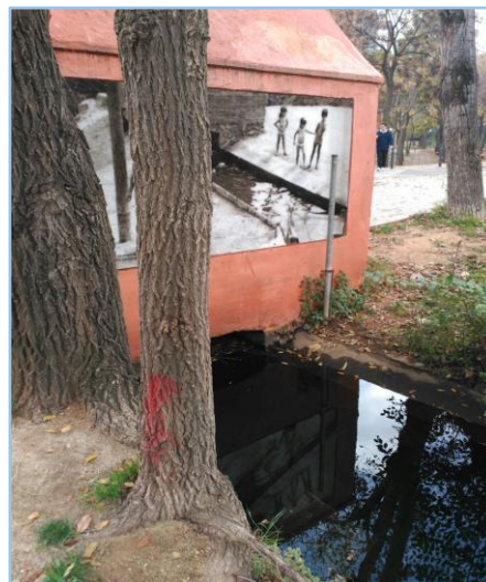
Figura 10 - Caseta de canvi d'aigües i canaló. Font: pròpia.
