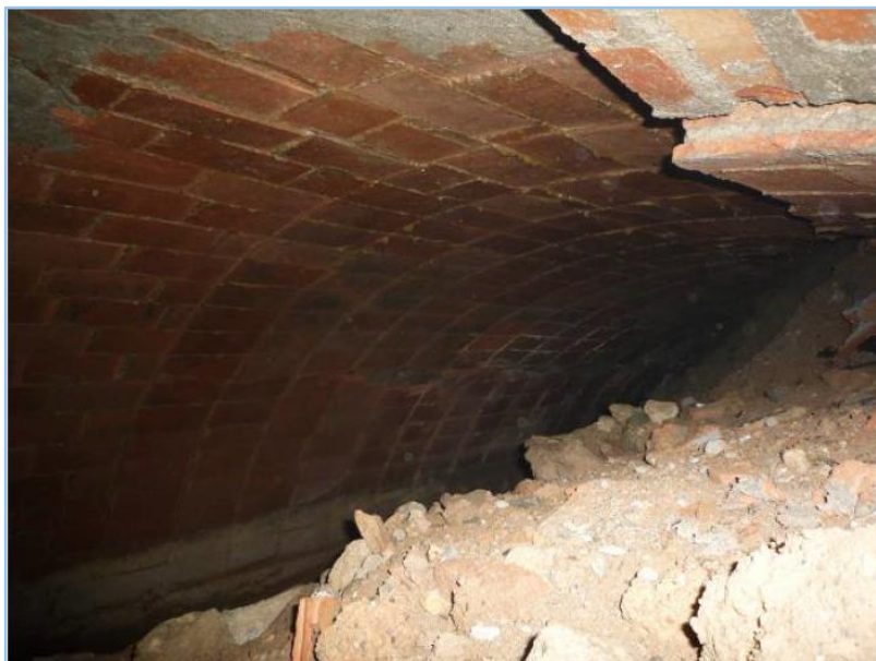
Figura 81 - Vista interior del col·lector documentat al carrer del Segre, amb la volta construïda a partir de filades de maons. Font: Pàmies, 2012.
