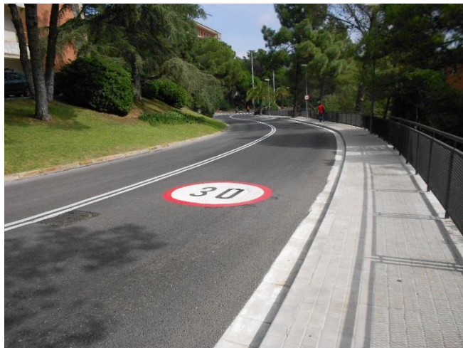
Figura 21. Nova vorera i senyalització de zona 30 al vial intern del Campus Mundet. Banc d'imatges OSSMA.
