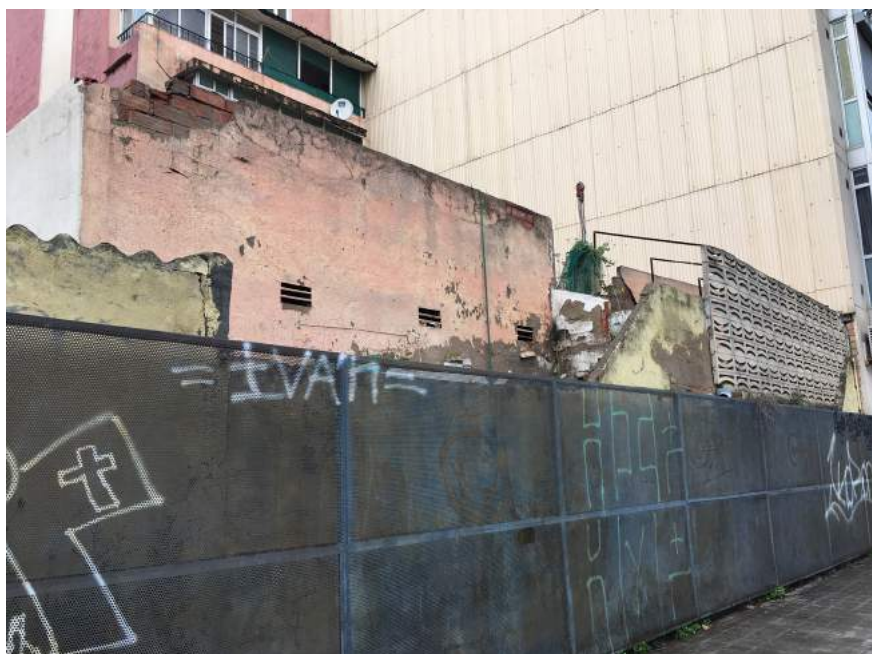
Fig. 138: Fachadas del plano vertical en mal estado Fotografía de la autora
