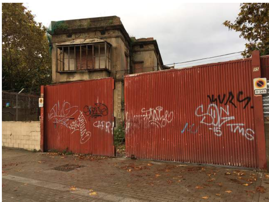
Fig. 114: Muro en malas condiciones en calle Foc Follet (lado norte) Fotografía de la autora
