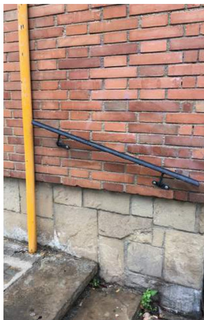
Fig. 89: Barras en el plano vertical como elementos de ayuda para personas de tercera edad Fotografías de la autora
