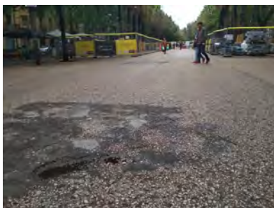
Defectos en el pavimento.
