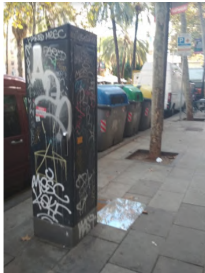
Cajas de control de servicios.
