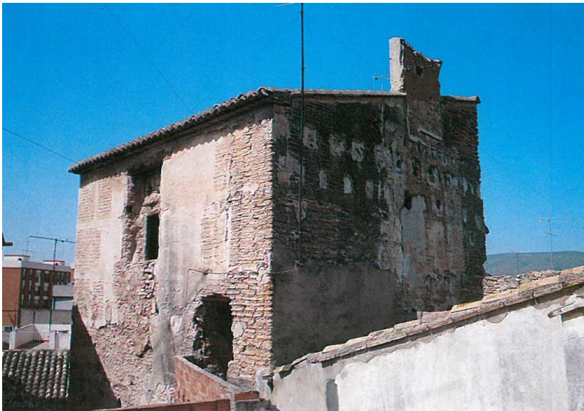
Fig. 50. Cara sud-est de la Torre de Canals abans de la seua restauració. Font: Cebrián, 1989, 98.
