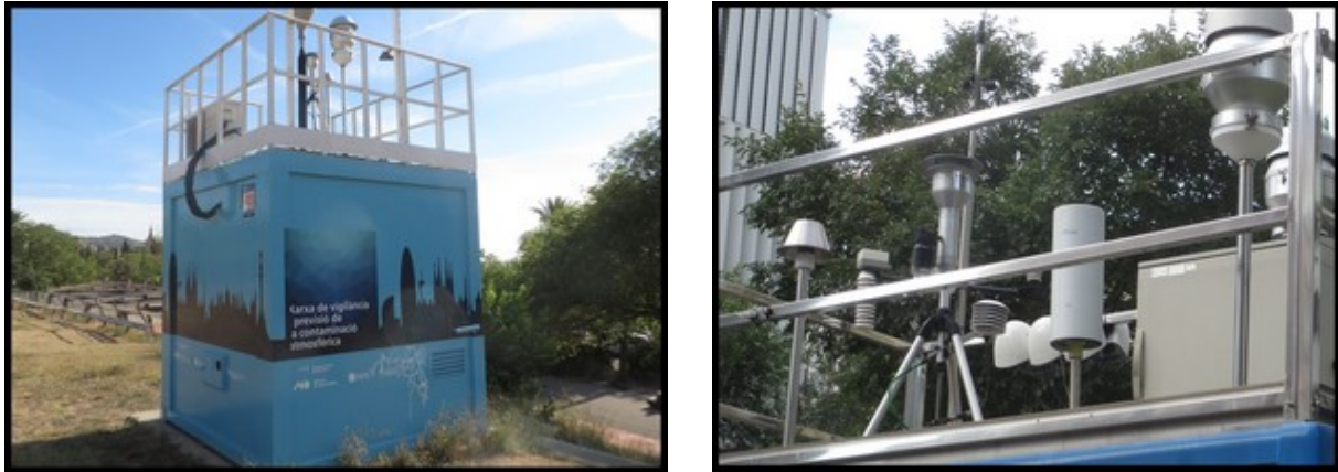
FIGURES 8 i 9: Imatge de l'Estació de Vall d'Hebron i dels aparells de mesura utilitzats a la Xarxa. FONT: Autor.
