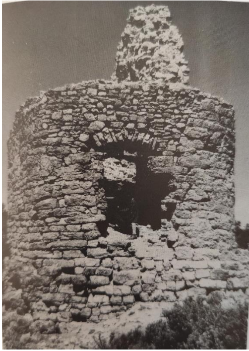
Fig. 6 Entrada de la torre, conservant encara la volta, actualment desapareguda. (Els Castells Catalans, vol III. (1992:643)
