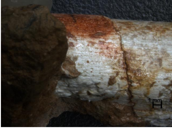
Figura 42, general zona 4 reverso sin sedimento y consolidado
