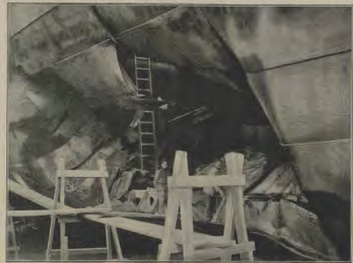
Un aspecte de l'avaría
