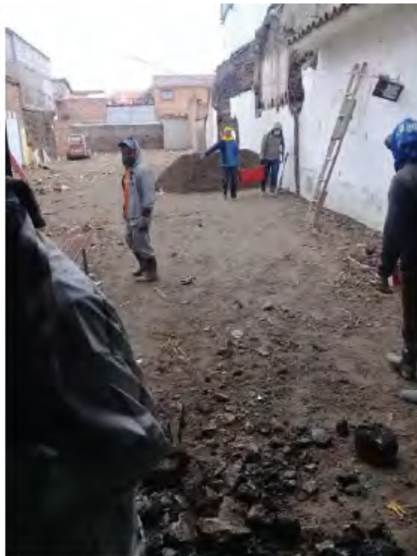
Figura 62. Solar del centro histórico de Cuenca tras la demolición de un inmueble por parte de su propietario que estaba catalogado como bien de valor arquitectónico. © Diario el Mercurio.
