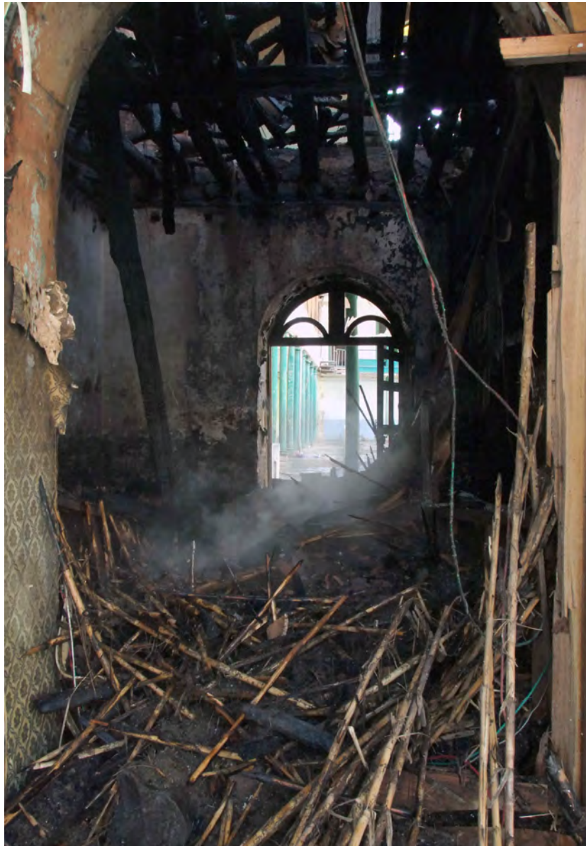
Figura 57. Detalle del Ingreso a la Capilla del Seminario San Luis después del incendio de agosto de 2012. Fotografía de Luis Cobos Chiriboga.
