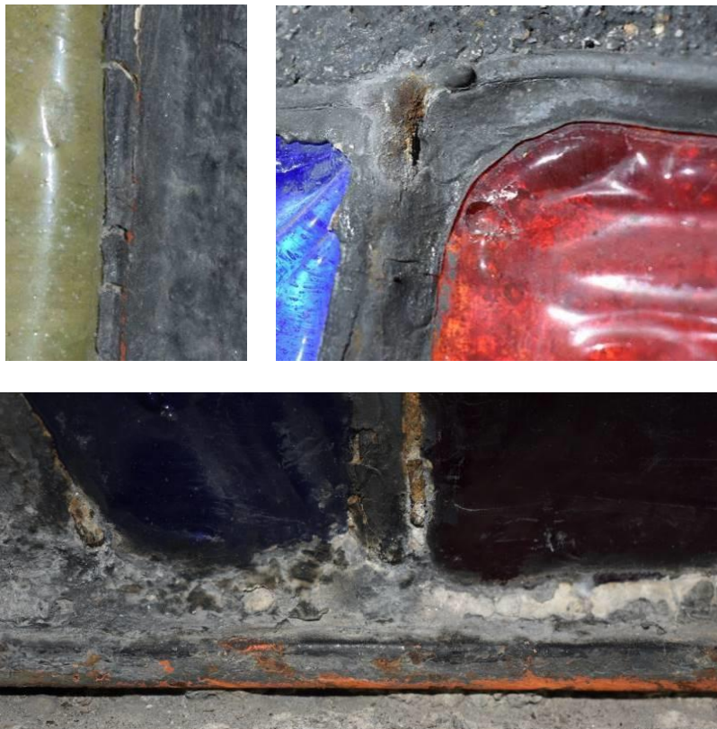
Detalls de la massilla aplicada entre les dalles i les platines perimetrals de dalles tipus Duxcrom . (Vitrall de ciment de l'església de Sant Domènec de Puigcerdà, de Joan Moncada i Regio Pistrina , 1963.) (Fotografies realitzades per Marta Golobardes. 2020.)
