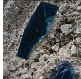
Pèrdua de material. (Erosió del formigó.)
