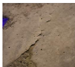
Fissura del formigó.
