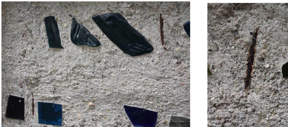
Parts de barnilles de l'armadura que han sobresortit a la superfície del formigó. (Fotografies realitzades per Marta Golobardes. 2021)
