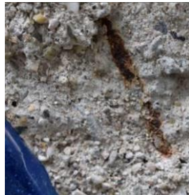
Tinció. (Taca d'òxid al formigó.)
