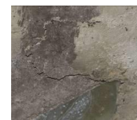
Deslaminació del formigó.
