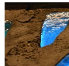
Pèrdua de formigó (erosió) i deslaminació.
