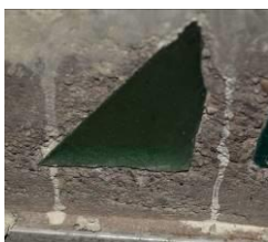
Decoloració. (Regalims de la restauració).
