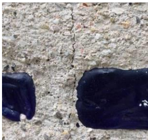
Fissura del formigó.
