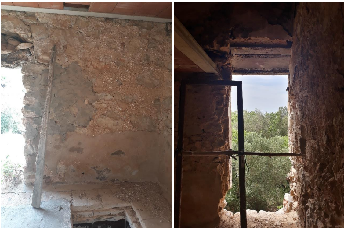
Fotografia 17: dos casos de reparacions posteriors sobre el morter original, al costat de l'obertura del primer pis a la paret sud. Fotografia 18: obertura a la paret oest del primer pis.
