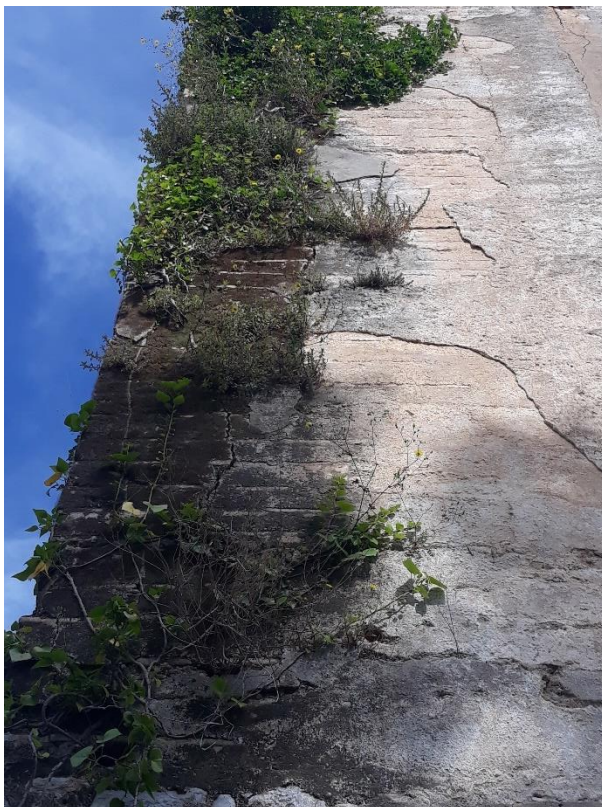
Fotografia 76: bioturbació: l'heura que creix a l'exterior està esquerdant parts de la paret.
