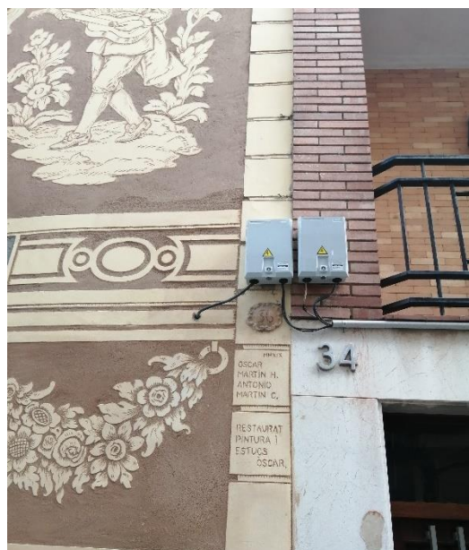
Fotografia 2: Els cables van per dins de la façana de Casa Sastre, 2021 (Foto: Martí Coral)
