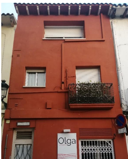
Fotografia 1: Canaletes de plàstic per cobrir cablejat al carrer Sant Bonifaci 44, 2021 (Foto: Martí Coral)
