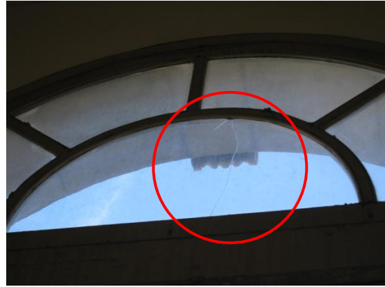
Fig. 30 Fissura en la forma semicircular de la tarja que correspon al finestral del tram superior de la caixa d'escala (Font pròpia)
