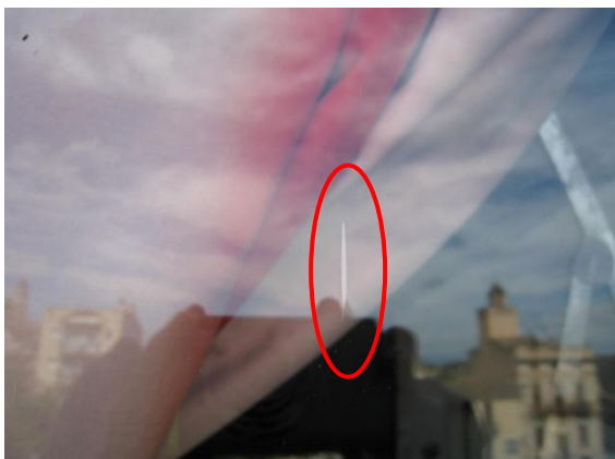
Fig. 25: Possible inclusió vítria classificada com a corda, observada en una de les portes d'accés al balcó de la façana principal. Font pròpia
