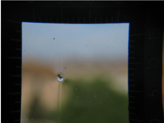
Fig. 27 Possible inclusió vítria classificada com a nòdul on s'hi visualitza un material atrapat en el seu interior. El defecte es troba localitzat a una de les portes d'accés al balcó de la façana principal. Font pròpia (7X)
