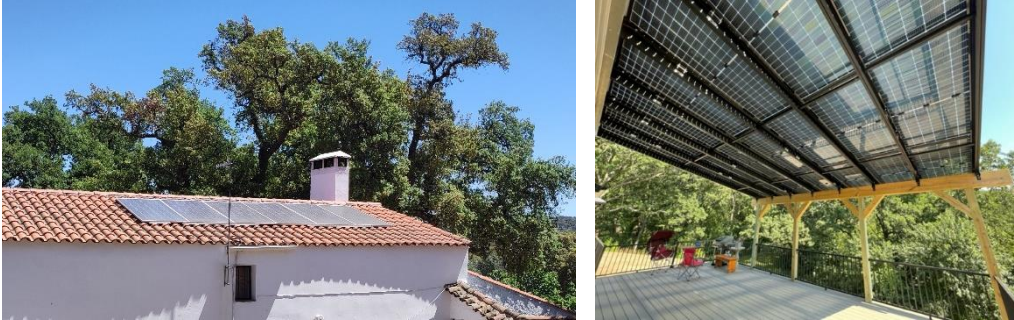
Imagen 32. En la primera imagen, instalación existente en la vivienda de una finca cercana. En la segunda imagen, instalación placas fotovoltaicas como elemento de sombreado
