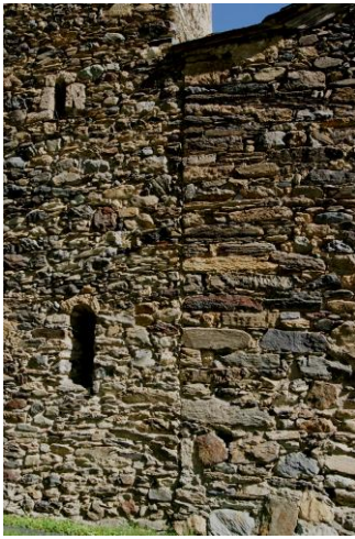
Figura 6. Unió entre el mur de la nau i el mur del campanar a la façana sud.
