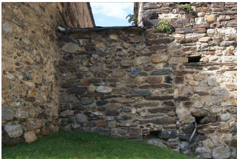
Figura 10. Diferència de parament en la unió entre el mur de l'habitació i el mur del campanar.
