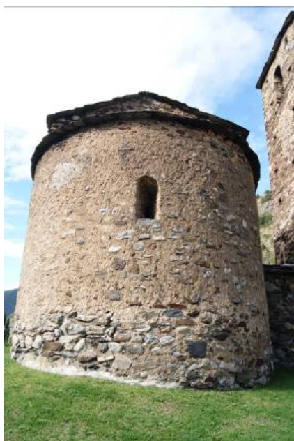
Figura 4. Finestra central de la capçalera de l'absis amb part de l'arrebossat conservat.
